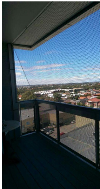
Πλέγμα τοποθετημένο σε μπαλκόνι για αποτροπή της φωλεοποίησης (πηγή: Pinterest)
